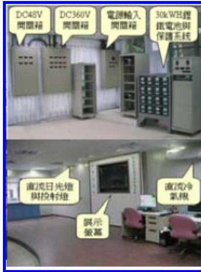
圖 12/智慧型直流電力屋內部組件
